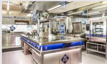
Großküche Herdanlage Kühlmöbel
